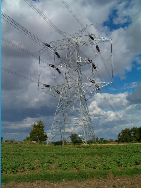
Línea doble circuito USA
