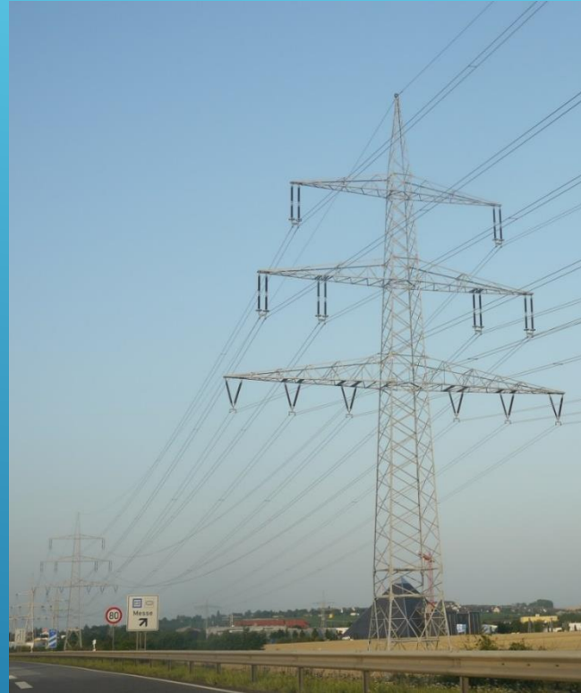
Torre múltiples circuitos USA
